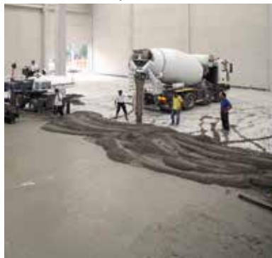
Piso de concreto sin juntas
